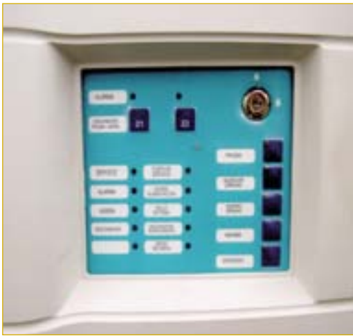
Fig.4.17. Central de control de incendios.
